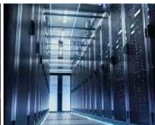
データセンター
