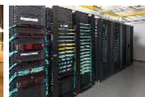
サーバラック
